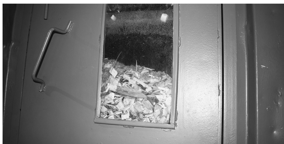
Электрический котёл «Гейзер» работает на щепе
